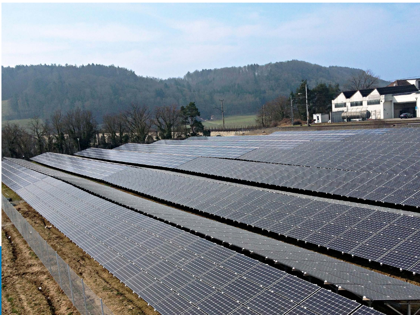
Freistehende Solaranlage, Eglisau, Industrie- und Gewerbezone
